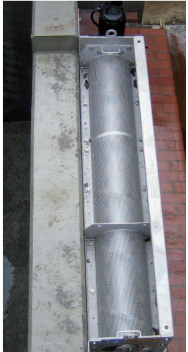
ROTAMAT® RoK 2安装在一雨水排放构筑物上
