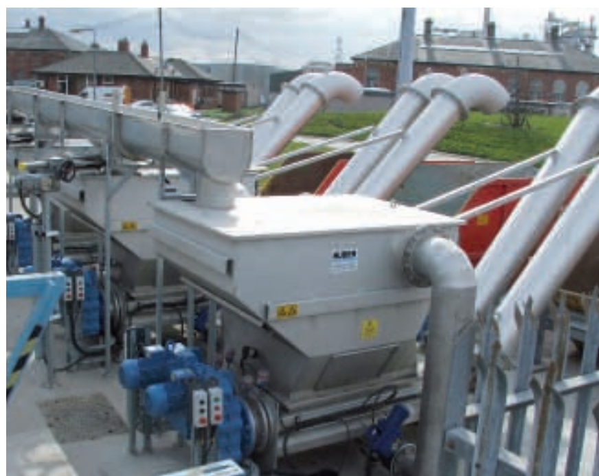
HUBER Wash Press WAP 12 SL, Knostrop (UK)
