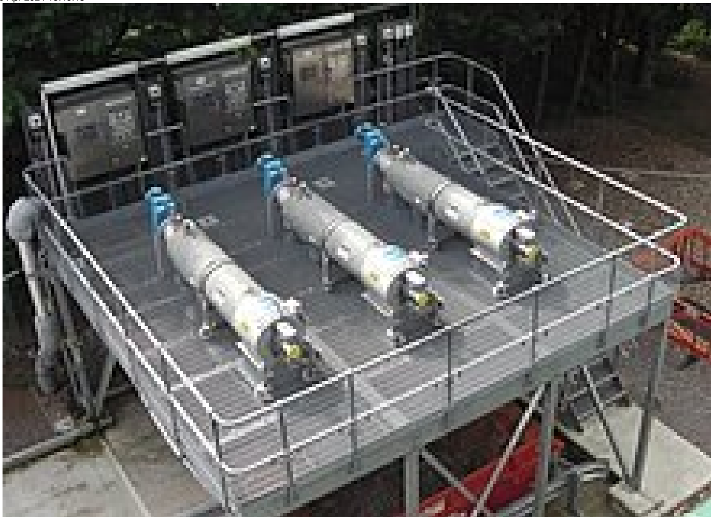
Fig. 4 - Tres máquinas STRAINPRESS® montadas sobre plataforma, con armarios de distribución y protección anticongelante
