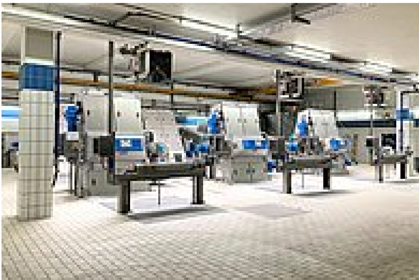
La «máquina de aniversario» RakeMax® en su versión básica en la entrada principal de una depuradora
